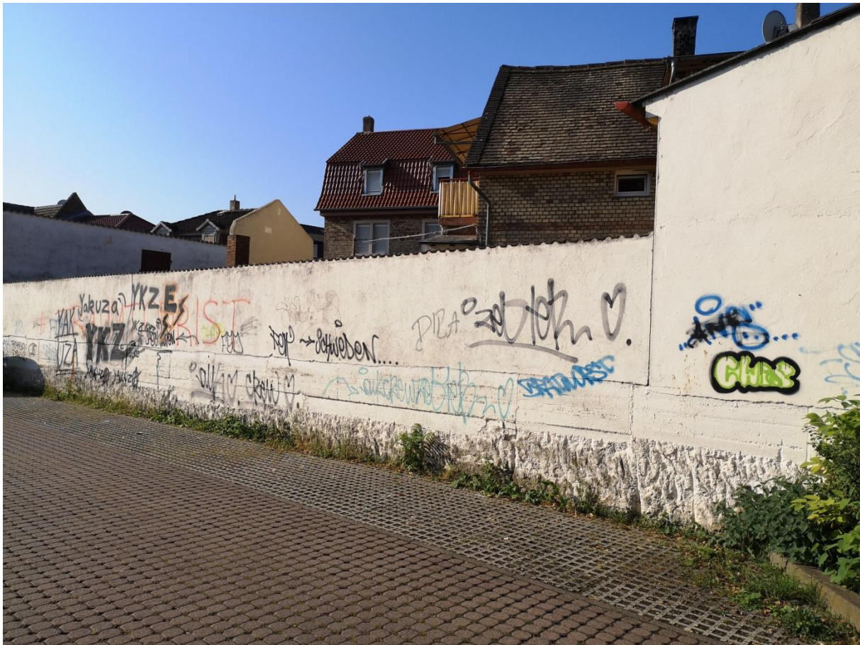
Aufnahme der Außenwand Bleichstraße 30 mit diversen Farbschmierereien
